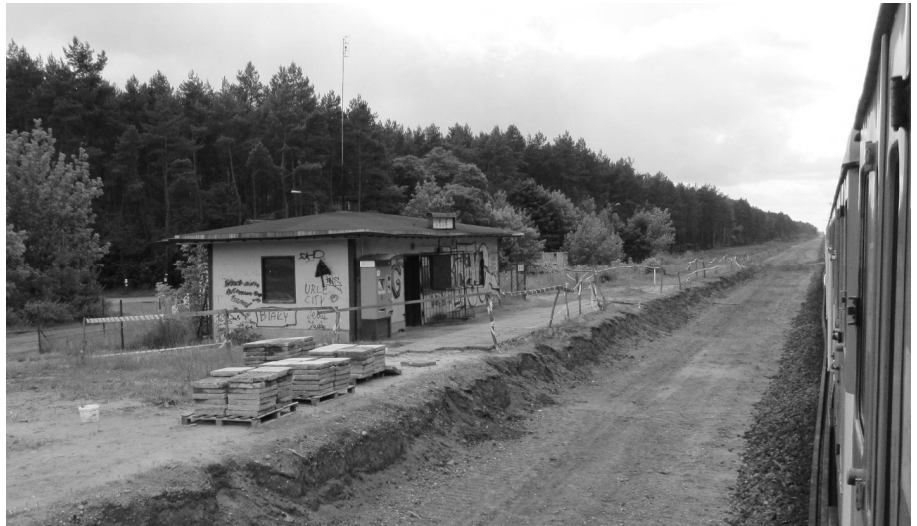
● Pograżona w pracach modernizacyjnych linia Warszawa - Białystok: pociąg Kolei Mazowieckich po zachowanym jednym torze mija przystanek Urle położony między Tłuszczem a Łochowem. Wkrótce przejazd tym odcinkiem w ogóle nie będzie możliwy.
