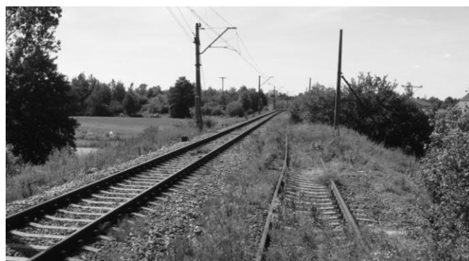
● Zapadnięty tor w miejscu osuwiska na linii Łuków – Skierniewice.
