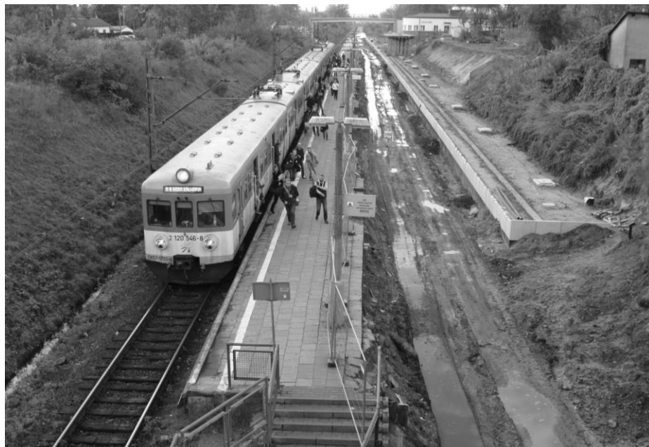
• Październik 2016 r., stacja Piaseczno w czasie modernizacji. Czy wkrótce piaseczyńska stacja będzie przebudowywana po raz drugi?
