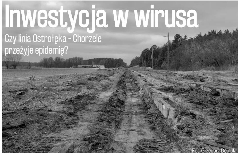
• Stadium prac na odcinku Ostrołęka – Chorzele w momencie ogłoszenia w kwietniu 2020 r. decyzji o przesunięciu funduszy z tego przedsięwzięcia na walkę z epidemią. Stacja Jastrząbka.
