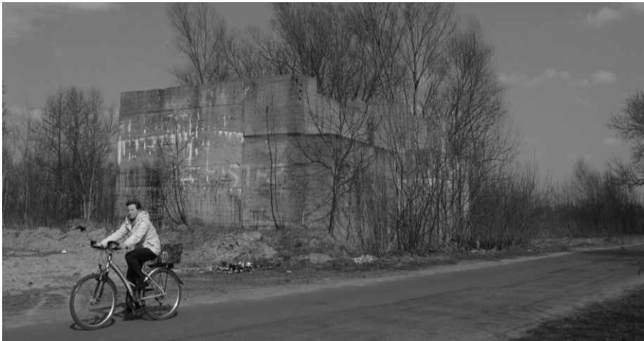
● Inwestycyjna ruina w Budach Zosinych koło Jaktorowa. Pozostałości po przyczółku wiaduktu na nigdy nieukończonym północnym odcinku Centralnej Magistrali Kolejowej.
