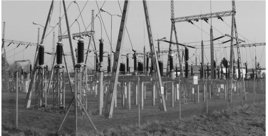
• Duża część majątku spółki PKP Energetyka jest ściśle powiązana z infrastrukturą kolejową, której w świetle prawa nie można prywatyzować. Podstacja trakcyjna w Hucie Zawadzkiej, zapewniająca zasilanie energetyczne Centralnej Magistrali Kolejowej.
