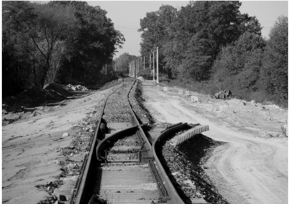
• Magistrala Warszawa – Lublin po wycofaniu się Astaldi z prowadzenia modernizacji: pozostałości starego układu torowego na stacji Motycz między Puławami a Lublinem.
