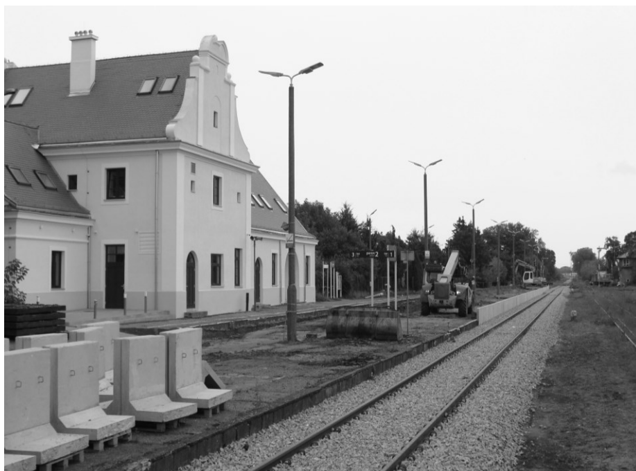
• Prace remontowe na stacji Płońsk oraz budynek dworcowy, który przeszedł gruntowną renowację po przejściu przez miasto.
